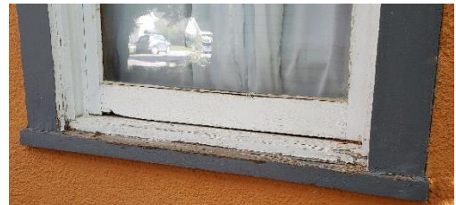
Window sill trim.
